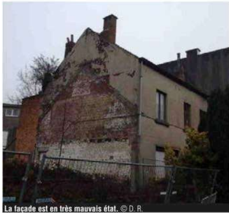
La façade est en très mauvais état. © D. R.
